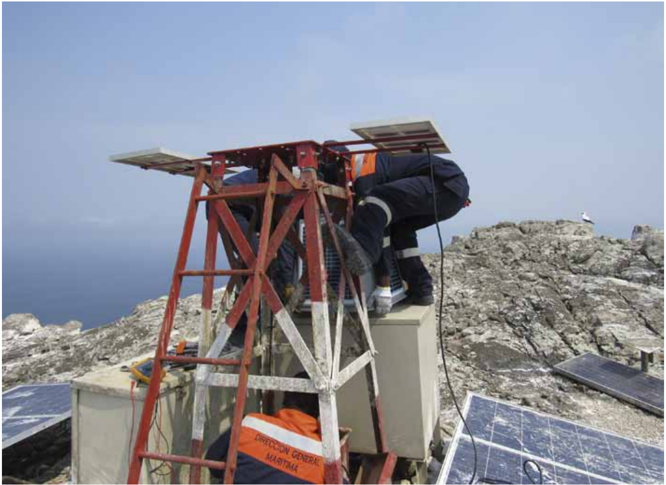
Imagen: La instalación de la linterna de luz autocontenida en el faro ubicado en la cima de Malpelo tuvo una duración de dos días. Fue un trabajo arduo para el personal de Señalización Marítima del Pacífico debido a que algunos sectores de la isla se presentan hasta 90° de inclinación, lo que dificulta significativamente tanto el ascenso como el descenso. Por: Archivo DIMAR.
